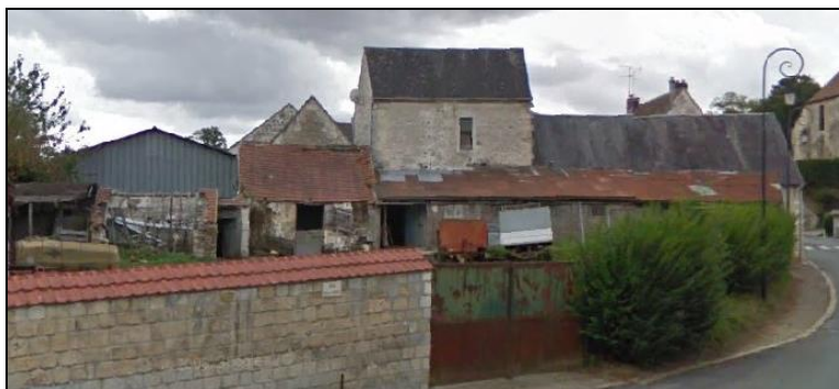
5) L'aspect dégradé des annexes
