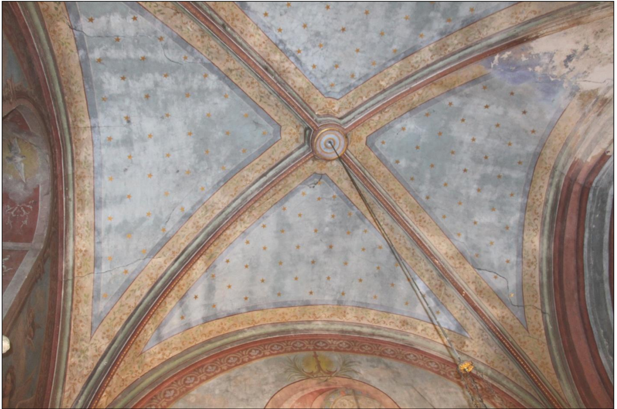
La voûte en bois et plâtre : ciel étoilé sur les vouîtains, frise au pochoir le long des arcs, soulignés en rouge vert et ocre et par des filets dorés.
